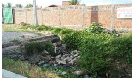
Fotografia 3 - Canal Pluvial como destino inadequado de resíduos sólidos na Baixa do CAIC
